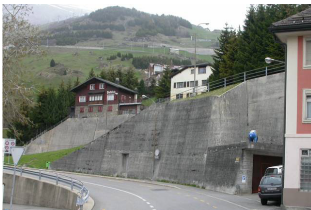
Abbildung 4-3: AAR-geschädigte Stützmauern in einem Dorf. Die besondere Bedeutung der Stützmauern ergibt sich durch die Situation im Dorf mit den darauf stehenden Bauten und der Strassenkategorie.
