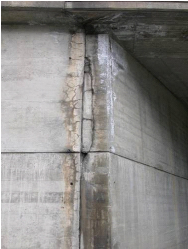
Abbildung 6-20: Widerlager einer Strassenüberführung: bei der undichten Fuge beim Fahrbahnübergang beginnt sich ein typisches Rissnetz abzuzeichnen.
