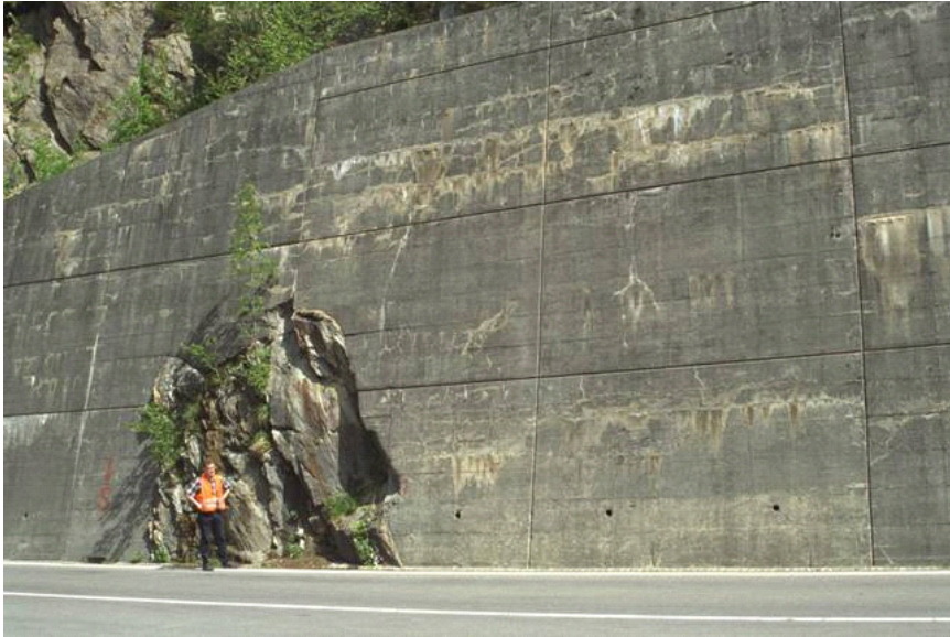
Abb. 6-5: Typisches Schadenbild für AAR bei einer Stützmauer: Risse sind netzartig und oft horizontal angelegt, mit unterschiedlichen Rissöffnungen, begleitet von weissen bis rötlich braunen Ausblühungen.
