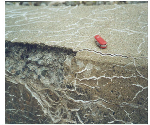
Fig. 3: Stark gerissener Beton mit weissen Ausblühungen, offenen Rissen und Abplatzungen infolge Frost, starkes Schadenausmass
