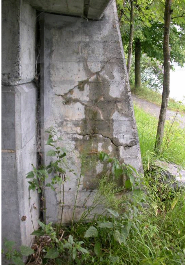
Abbildung 6-24: Seitenansicht einer Stütze bei einem Lehnenviadukt: die offenen Horizontalrisse dringen tief in den Beton ein.
