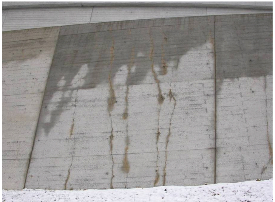
Abbildung 6-14: Ausgeprägte Vertikalrisse durch Fröhschwindrisse induziert, mit rötlichen Ausblühungen bei einer Stützmauer. Die AAR ist eine Folgeerscheinung der erhöhten Durchfeuchtung entlang der Risse.
