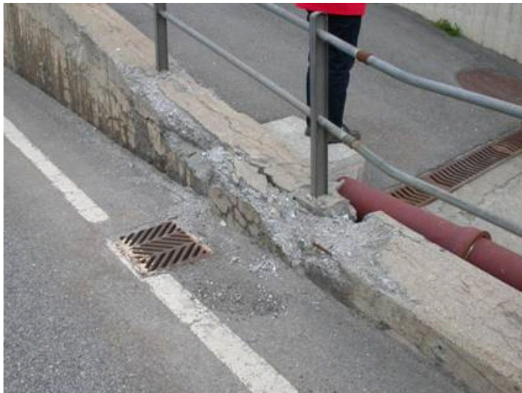
Abbildung 2-8: Frostausalzschäden kombiniert mit AAR bei einer Stützmauer.
