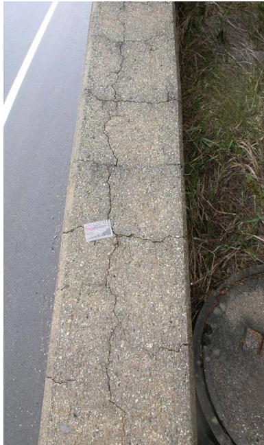
Abbildung 6-11: Mittig angelegte Vertikalrisse, mit abzweigenden Begleittrissen.
