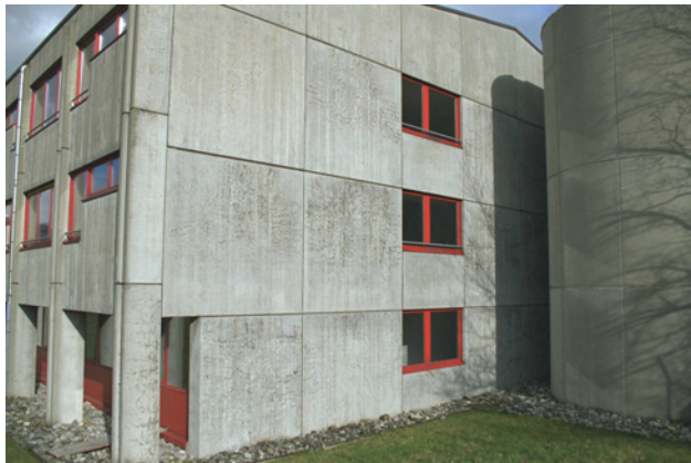
Abbildung 6-41: Vorfabrizierte Fassadenelemente mit markanten Rissbildern
