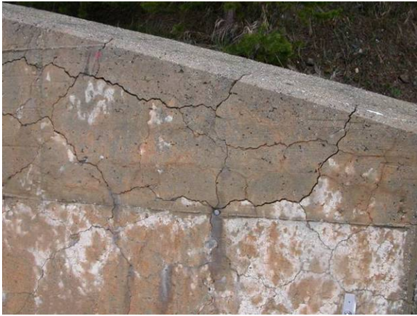
Abbildung 6-6: Risse entlang einer abgeschrägten Mauerkrone.
