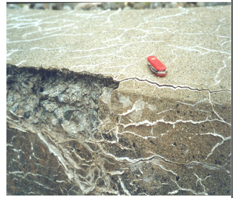
Fig. 3: Béton fortement fissuré avec des efflorescences blanches, des fissures ouvertes et des éclatements dus au gel, forte dégradation
