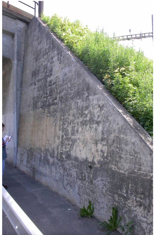
Abbildung 6-21: Flügelmauer einer Eisenbahnüberführung mit groben Rissnetz.
