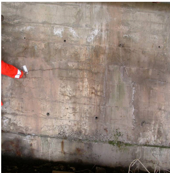
Abbildung 6-29: Horizontale Risse über Spannglieder in einem Wandelement.
