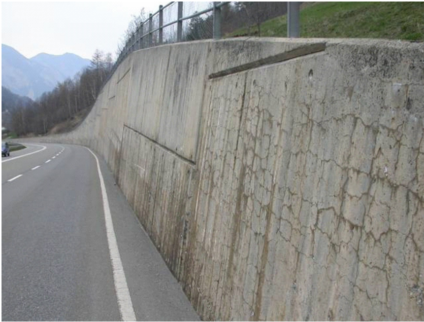
Abbildung 2-10: Betonieretappen einer Stützmauer, die sich durch ihr oberflächliches Rissbild deutlich voneinander unterscheiden.
