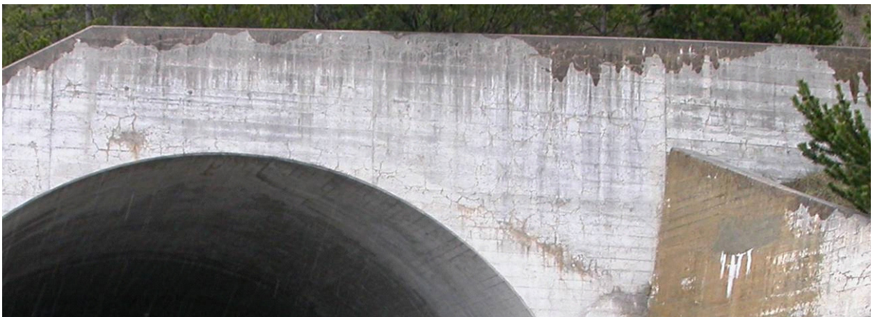
Abbildung 6-37 (unten): Portalscheibe und Flügelmauer mit dunklem Rissnetz
