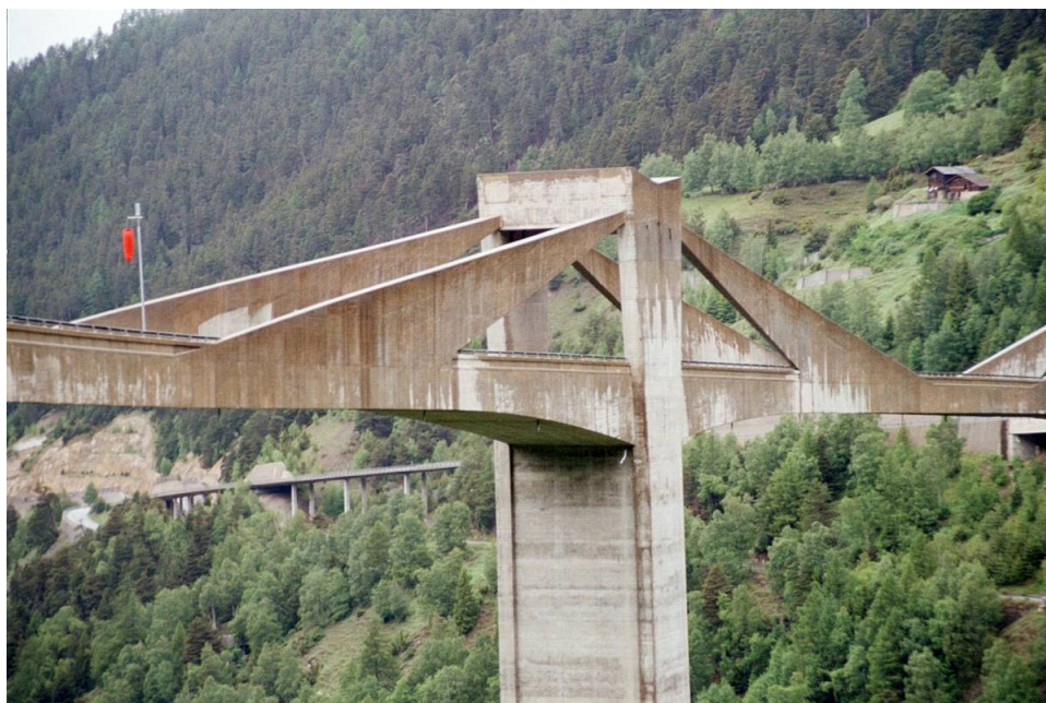
Abbildung 6-15: Bei der Ganterbrücke werden die Segel, Pylone und die Brückenkastenwände bei schlechtem Wetter regelmässig stark durchnässt. In diesen Bauteilen sind Anzeichen von AAR vorhanden.
