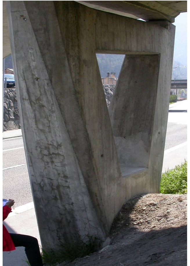
Abbildung 6-25: Stütze mit dunkeln Rissen auf der exponierten Seite.
