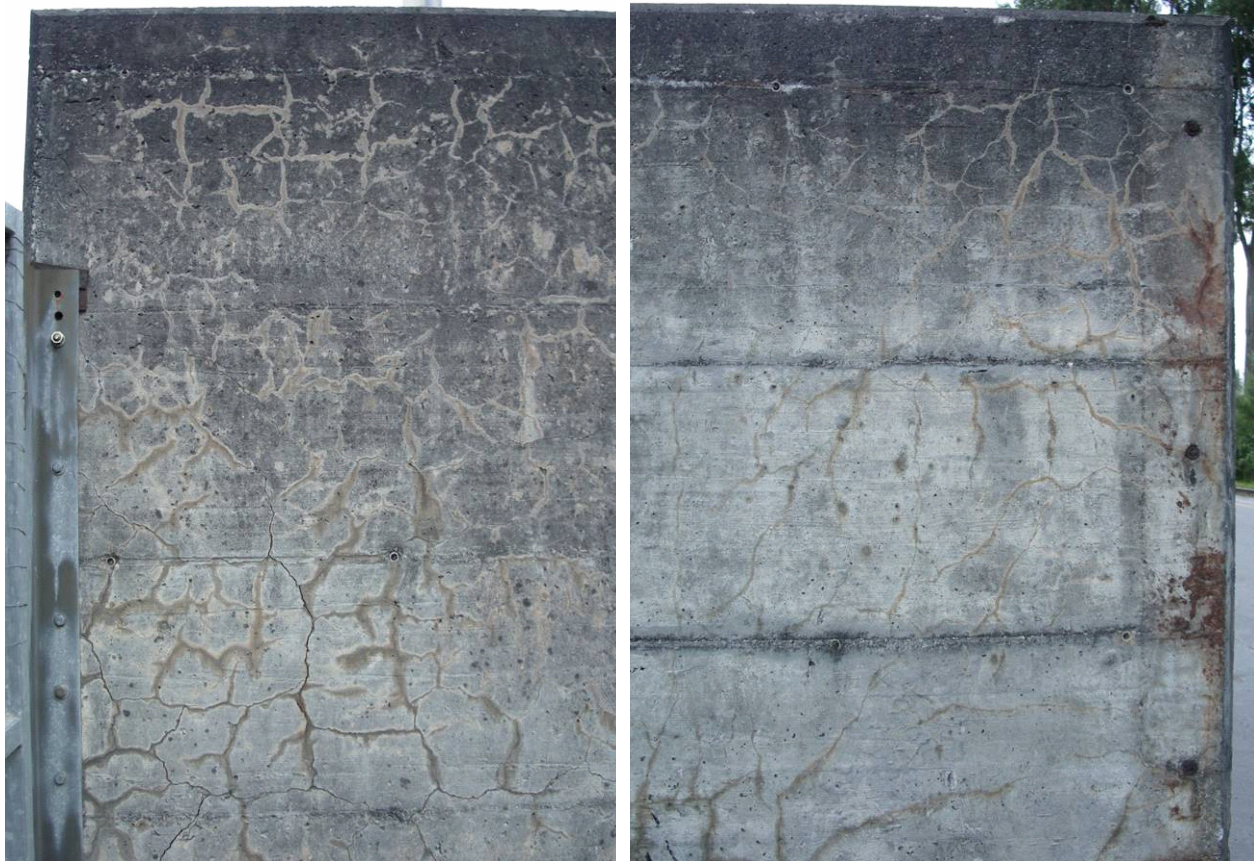
Abbildung 6-43: Freistehende Mauer: Südseite mit markantem Rissnetz (links); Nordseite mit Rissen vor allem in der Mauerkrone (rechts)
