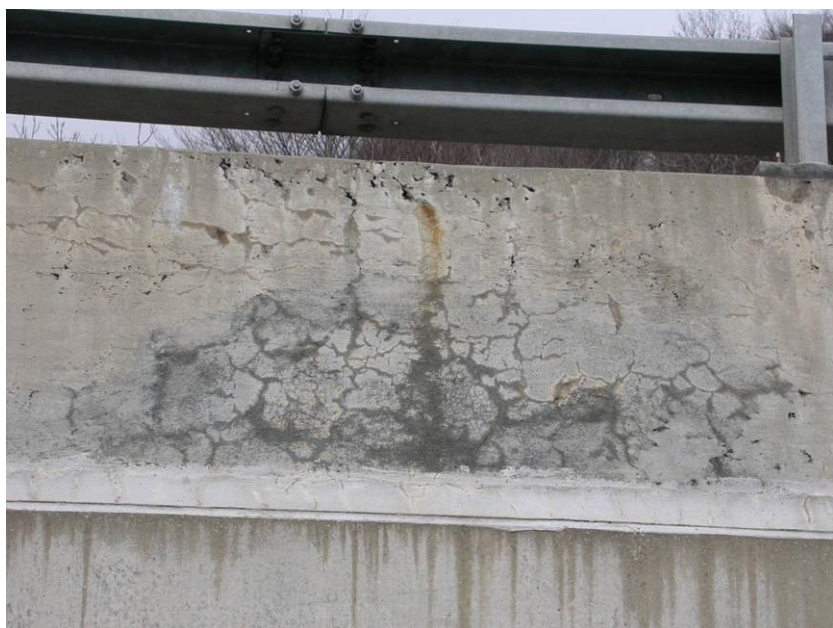
Abbildung 6-16 (links): Feines, sich dunkel abzeichnendes Rissnetz bei einer Brüstung.
