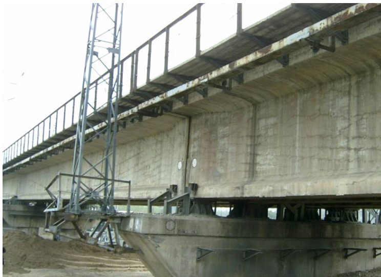
Abbildung 2-11 (oben): Vorgespannter Brückenkasten: die dunkeln Risse folgen der Lage der Spannglieder (Beispiel aus China).
