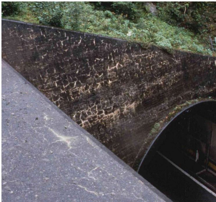
Abbildung 6-33 (oben links): Lawinengalerie mit gerissenen Stützen
