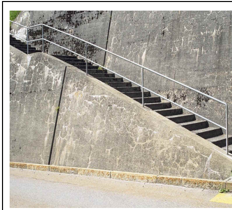
Fig. 1: Mur de soutènement avec fissures polygonales; fissuration plus intensive dans les zones plus exposées (humides), dégradation moyenne
