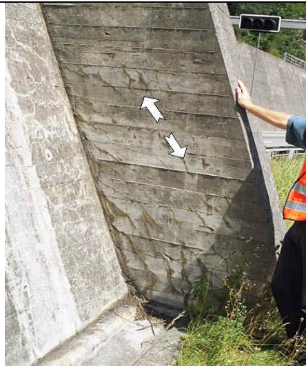
Fig. 5: Portail de tunnel avec des fissures orientées diagonalement et des efflorescences sombres, dégradation moyenne
