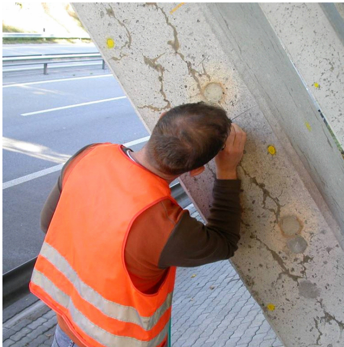
Abbildung 6-26: dunkel hervortretendes, lang gezogenes Rissnetz einer Stütze.
