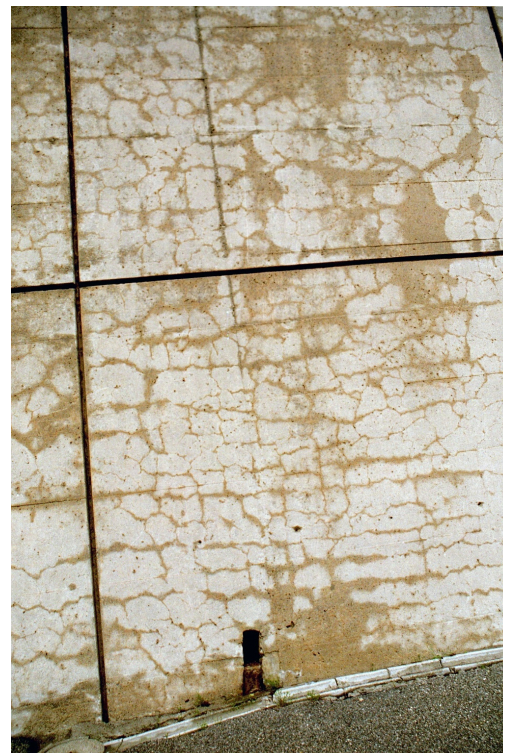
Abbildung 2-12 (rechts): Stützmauer mit hoher Bewehrungsdichte: die Risse folgen bereichsweise der Geometrie der Bewehrungsstäbe.
