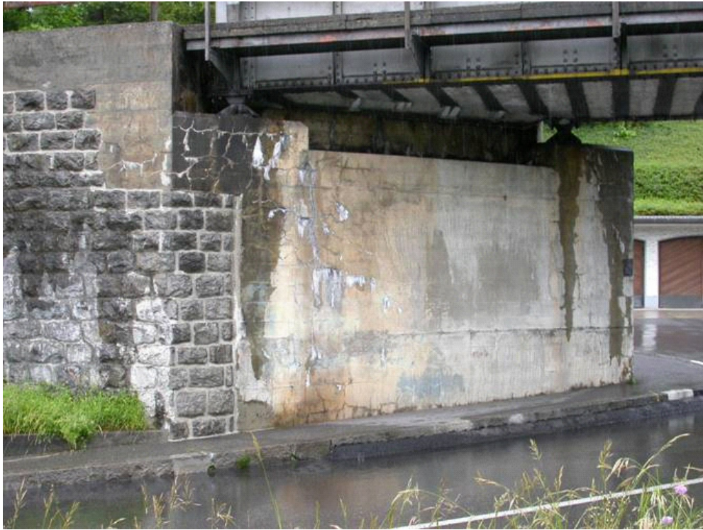
Abbildung 6-19: Netzartig angelegte Risse mit Ausblühungen bei einem Widerlager. Auffällig ist auch die rötliche Verfärbung der Betonoberfläche, welche häufig bei AAR-Schäden auftritt.
