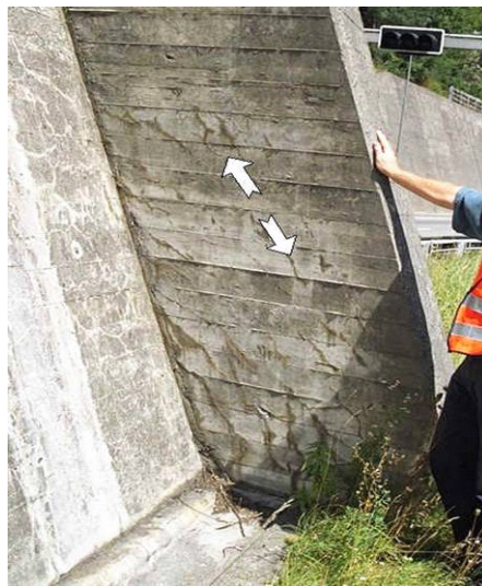
Fig. 5: Tunnelportalscheibe mit orientierten Diagonalrissen und dunklen Ausblühungen, mittleres Schadenausmass
