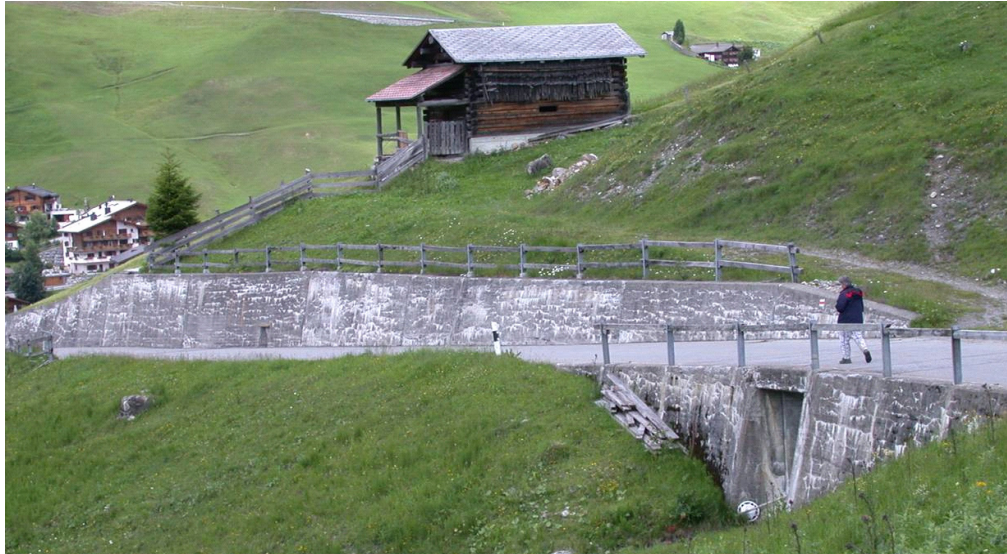
Abbildung 6-50: Anzeichen von AAR bei kleineren Bauten in Berggebieten mit auffälligen, von hellen Ausblühungen markierten Rissbildungen.
