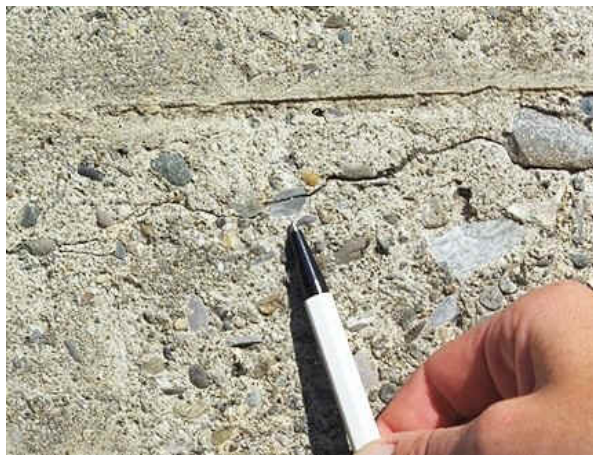
Fig. 7: Surface de béton avec tracé typique d'une fissure à travers le granulat.
