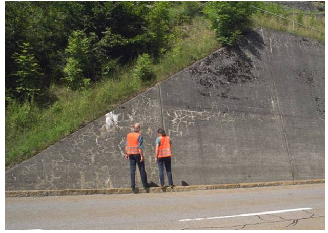
Abbildung 6-7: unterschiedlich stark geschädigte Betonieretappen.
