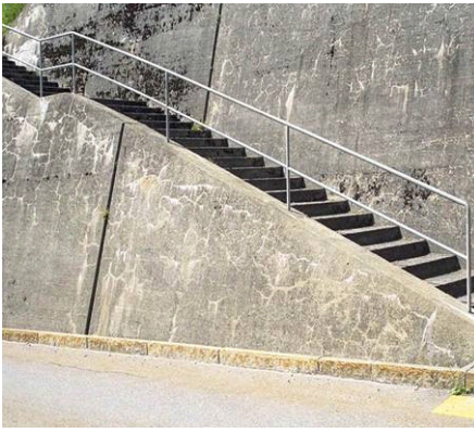
Fig. 1: Stützmauer mit polygonalen Rissen infolge AAR; höhere Rissdichte in stärker durchfeuchteten Bereichen, mittleres Schadenausmass
