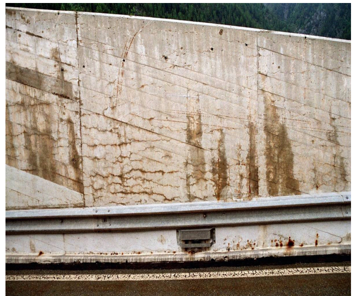
Abbildung 6-30: Horizontale Risse zwischen den Spannglieder eines Brückensegels
