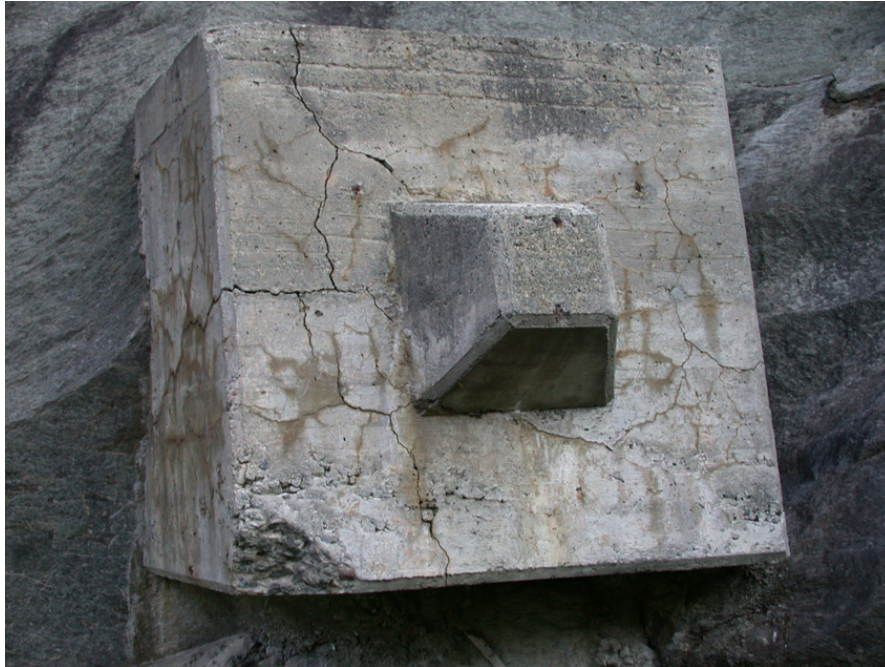
Abbildung 2-1: Bis mehrere Millimeter breite Risse in einem Ankerblock, die durch die Ausdehnung des Betons infolge AAR entstanden sind.
